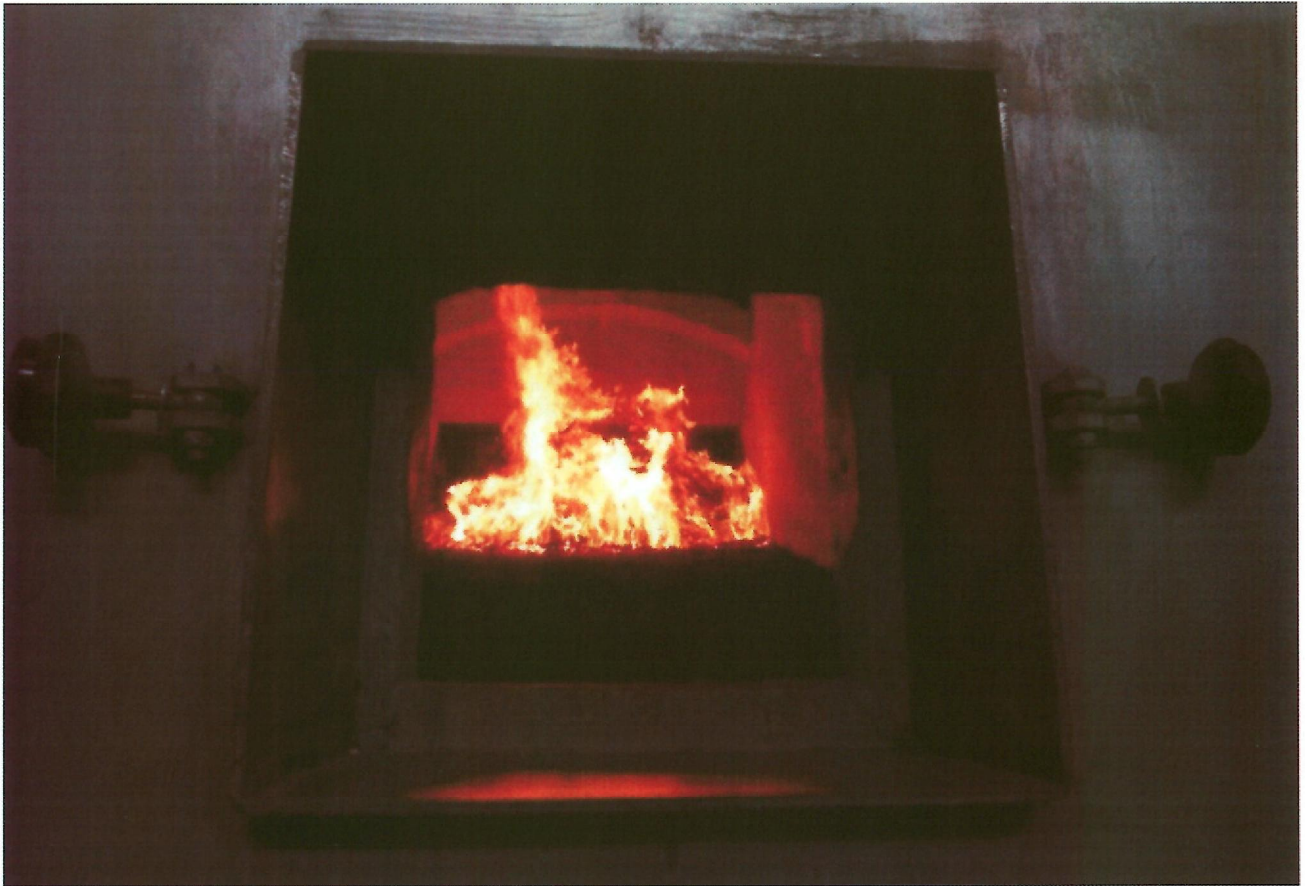
5. Pohled do kotle 23.10. 2017
